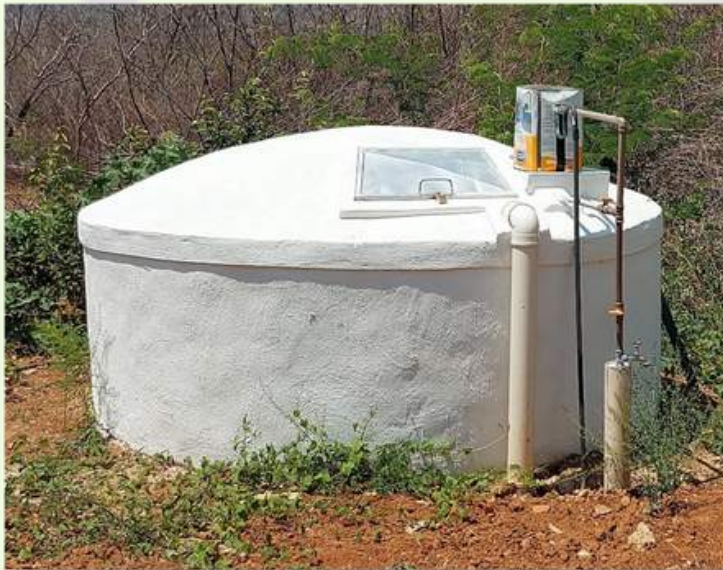
Cisterna de ferro cimento
