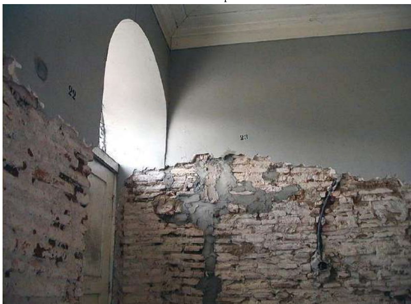
Figura 15 – Foto do contato da parede G com a parede A, mostrando o arco da porta entalado
