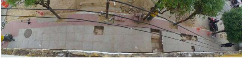
G: Panorâmica superior da escavação geral da AV, a partir da fachada e do 1ª andar da atual edificação.
