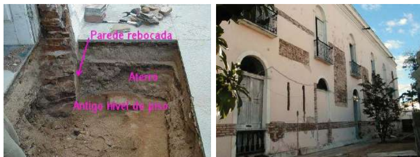
Figura 5 – Fachada lateral esquerda, vendo-se os antigos vãos entaipados
