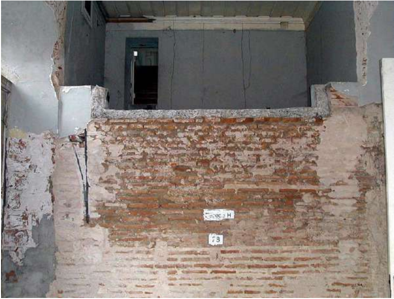
Figura 16 – Foto da parede H, mostrando os tijolos diferentes e a laje instalada
