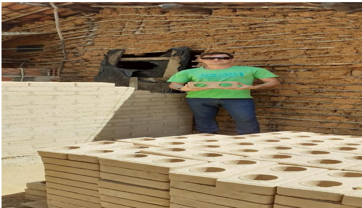
Figura 6: Levantamento com os tijolos já Hidrocureados e endurecidos para o banheiro Solidário, de Dona Zefinha e sua Família.
