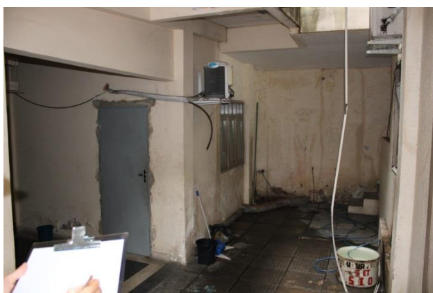
Foto 2: Entrada cozinha FMAC e as patologias do local
